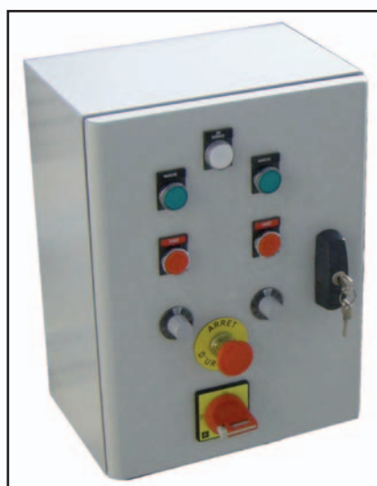
Coffret réalisé pour l'alimentation de 2 variateurs.
